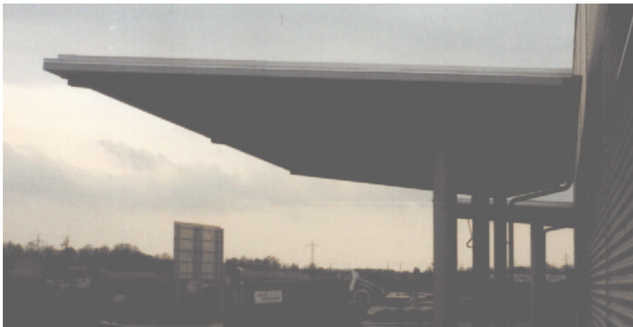
Das Vordach ruht auf zwei Stahlstützen. Es besteht keine Verbindung mit der Gebäudeaußenhülle - eine gute konstruktive Lösung.
